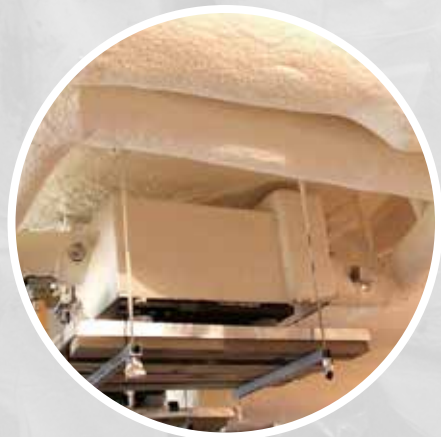
Dutos e penetrações
