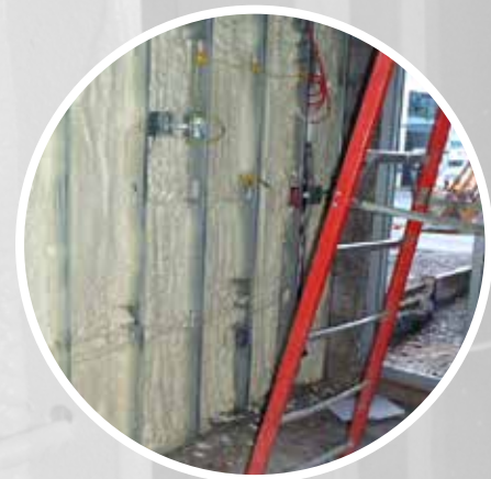
Cavidades na parede
